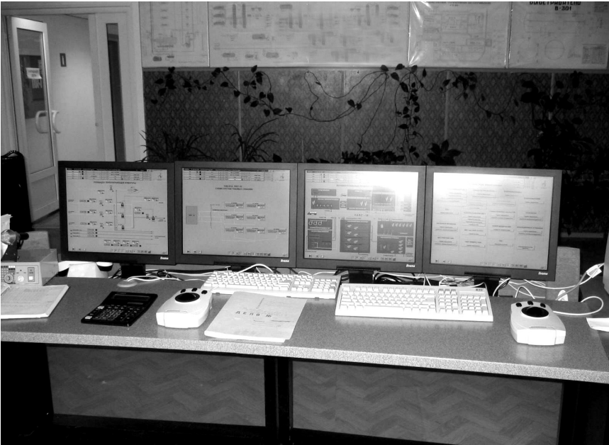
▲ Фото операторной блока вспомогательных помещений (БВП)
