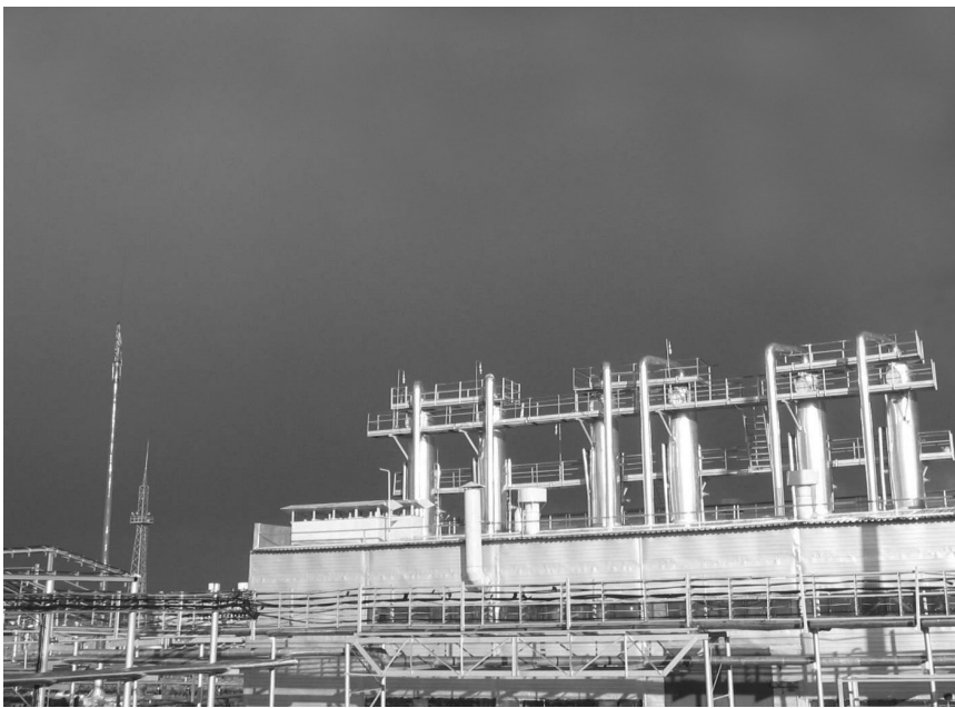
▲ Газовый промысел Уренгойского газоконденсатного месторождения ГП-10
