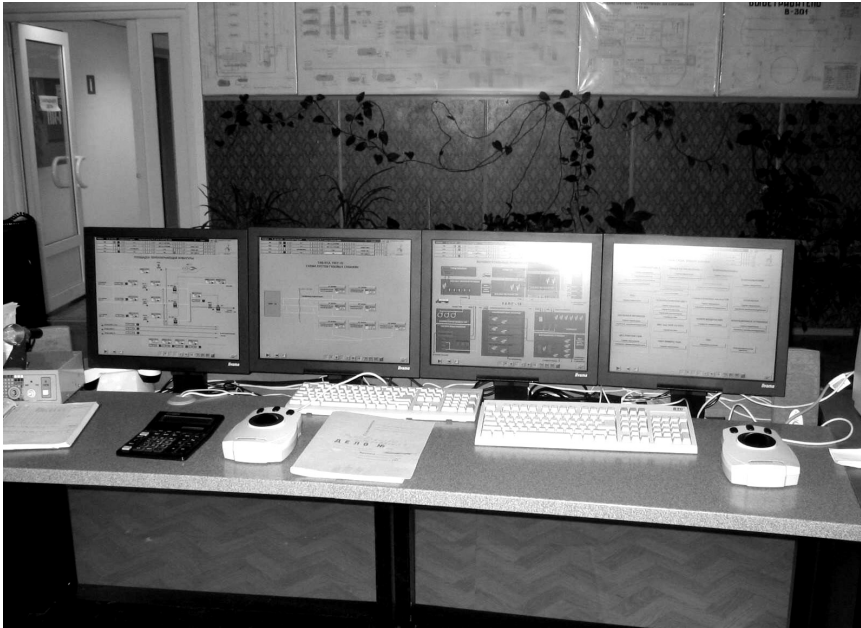
▲ Фото операторной блока вспомогательных помещений (БВП)
